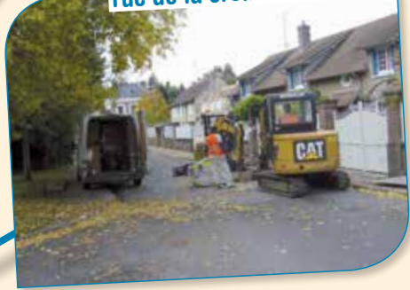
Reprise des canalisations et des compteurs d'eau, rue de la croix Blanche
